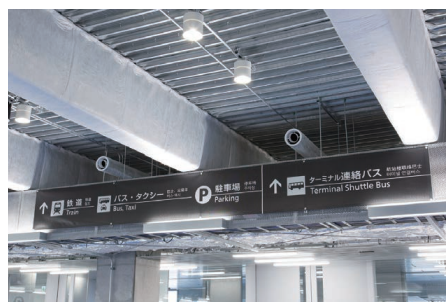
サインに活用された設備梁
