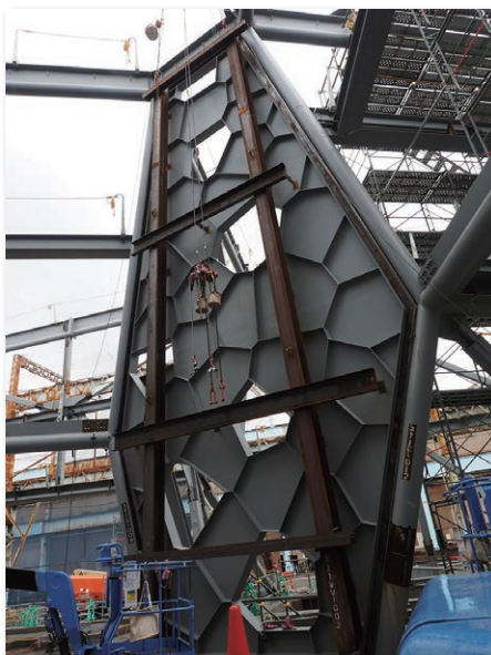
建方用の補強部材が付いている設置中のポロノイ耐震壁
